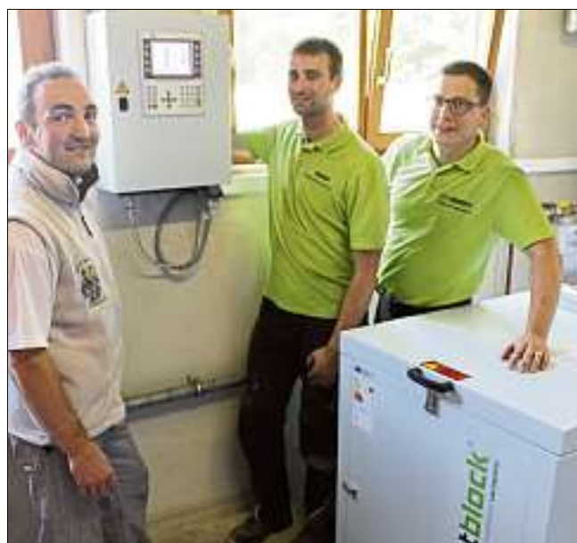
Firmenchef Heiko Baier (links) und Mitarbeiter des Firmennetzwerks Eigenenergie zeigen das neue Blockheizkraftwerk im Schömberger Café Baier.
